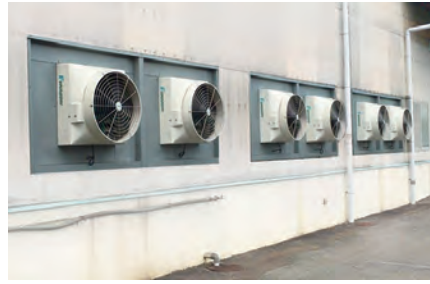
中部製罐株式会社 13台 (三重県鈴鹿市)
